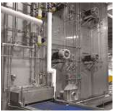
External fan motors
